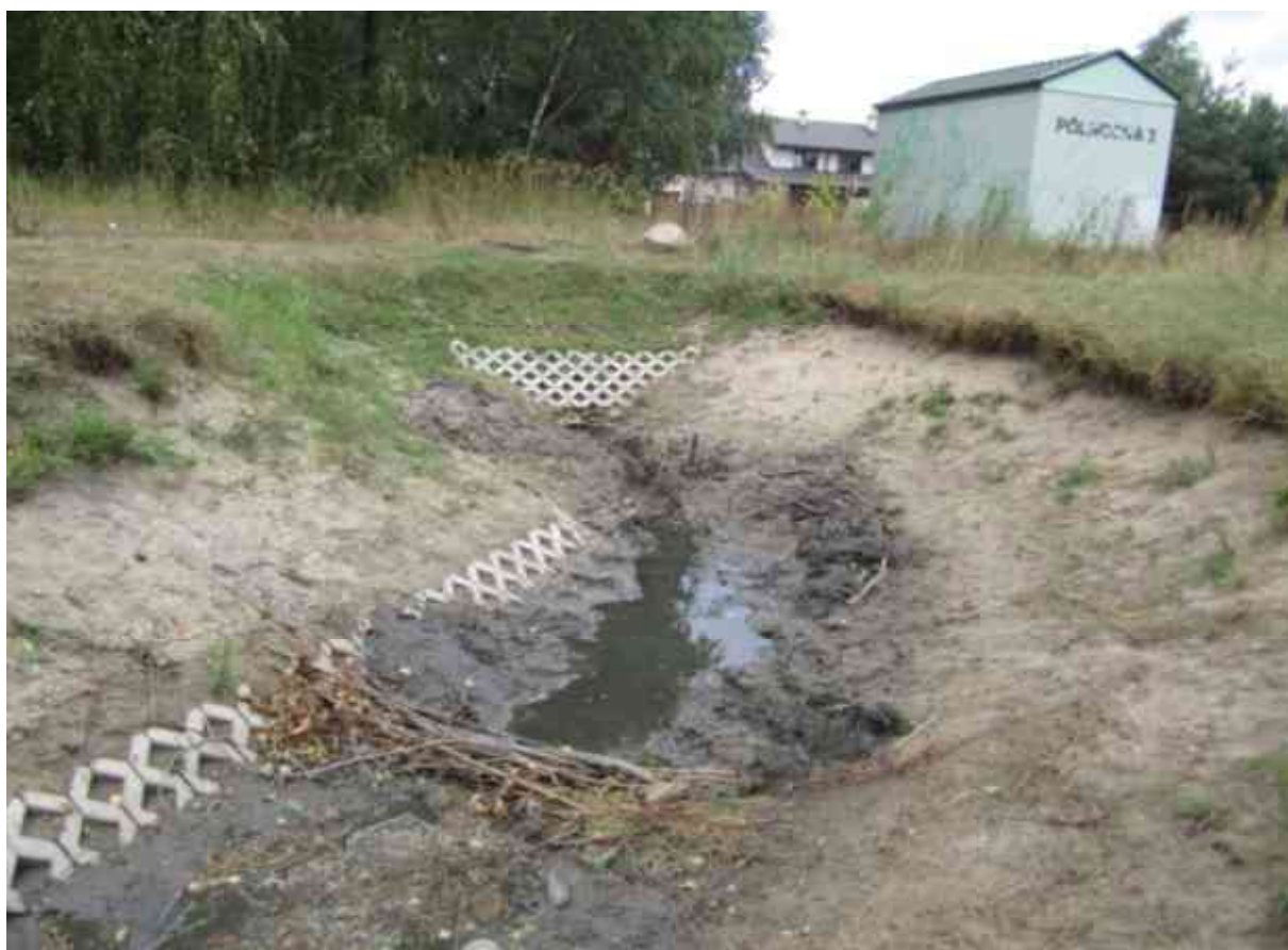
Fot. 236. Wysychający rów rozsączająco-odparowujący. (MM)
